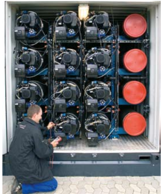
Der Vorbehandlungscontainer besteht aus 12 PBRs und hat Platz für weitere Reaktoren, die bei größerem Kapazitätsbedarf zugeschaltet werden können.
